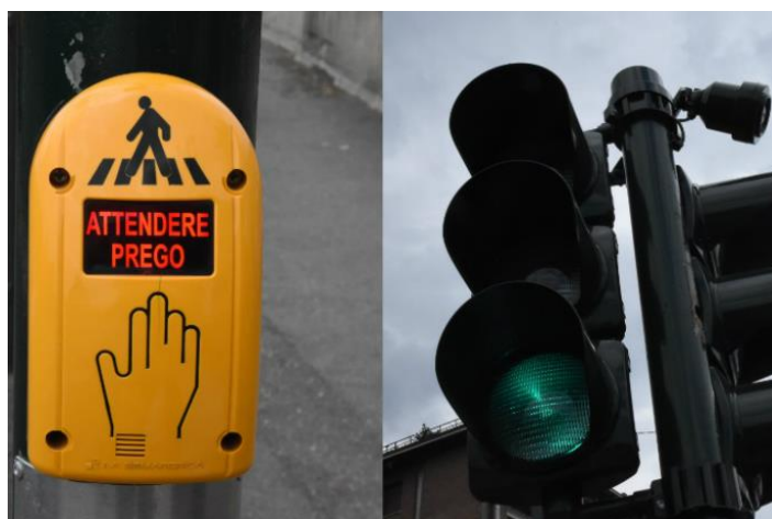
Esempi di dispositivi acustici installati sui semafori
